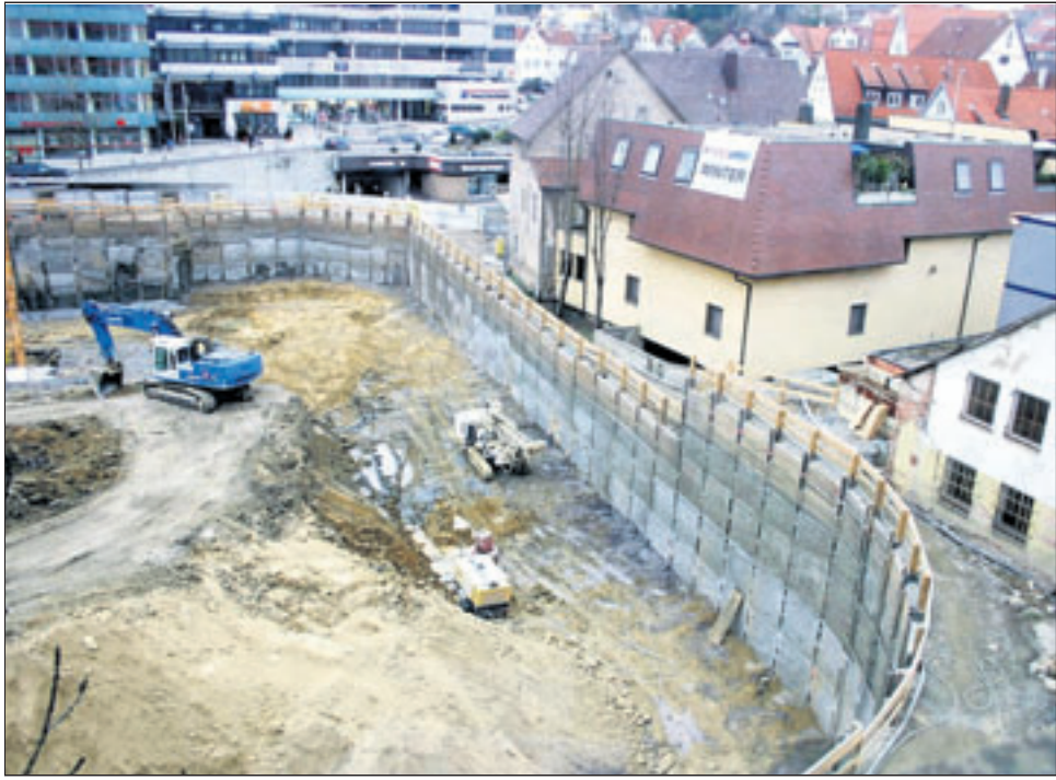
Die Großbaustelle „Alter Postplatz“ ist „auf dem Grund“ angekommen. Rechts (mit braunem Dach) das „neue“ Sport-Winter-Gebäude, links daneben das alte; beide werden abgerissen, der künftige „Kleine Postplatz“ wird gänzlich neue Einblicke in die Innenstadt erlauben. Fotos: David
