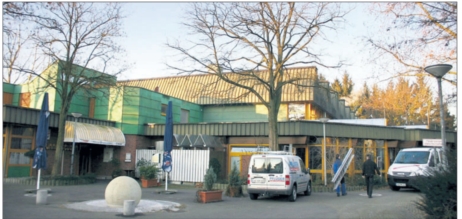
Letzte Hand legen die Handwerker an, bevor die Beinsteiner Halle nach einer gründlichen Generalsanierung am Samstag, 8. März 2008, wieder ihrer Bestimmung übergeben wird. Die Beinsteiner laden aus diesem Anlass zu einer „Kultnacht“ ein. Foto: David
