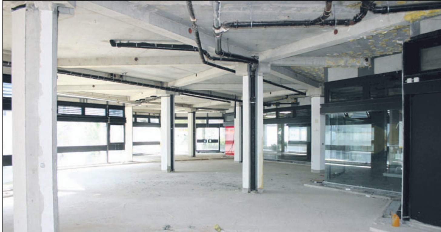
Im September soll mit den Rohbauarbeiten im Marktdreieck begonnen werden. Nach dem Entkernen und bei genauerem Hinsehen wurde festgestellt, dass die Statik des Gebäudes wegen der später veränderten Lastverteilung zusätzlich ertüchtigt werden muss. Geplant ist, dass die Stadtbücherei Ende 2010 die renovierten und umgebauten Räume wieder bezieht. Foto: David
