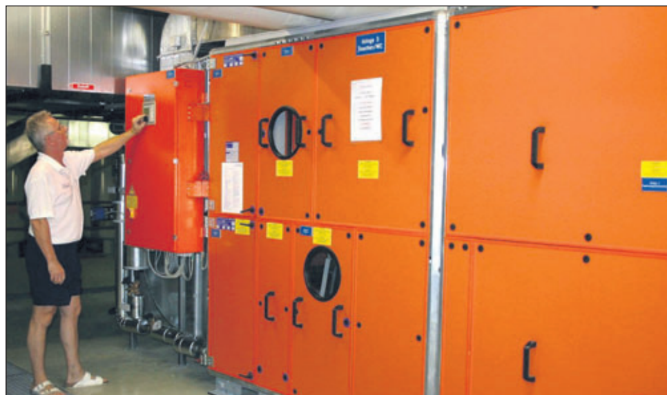
So sehen sie aus, die technischen Elemente der neuen Lüftungsanlage, die, im Keller und auf dem Dach des Bads installiert, für gutes Klima im gesamten Schwimmbadbereich sorgen. Badbetriebs-leiter Joachim Liedtke kennt sich mit den neuen Aggregaten aus.
